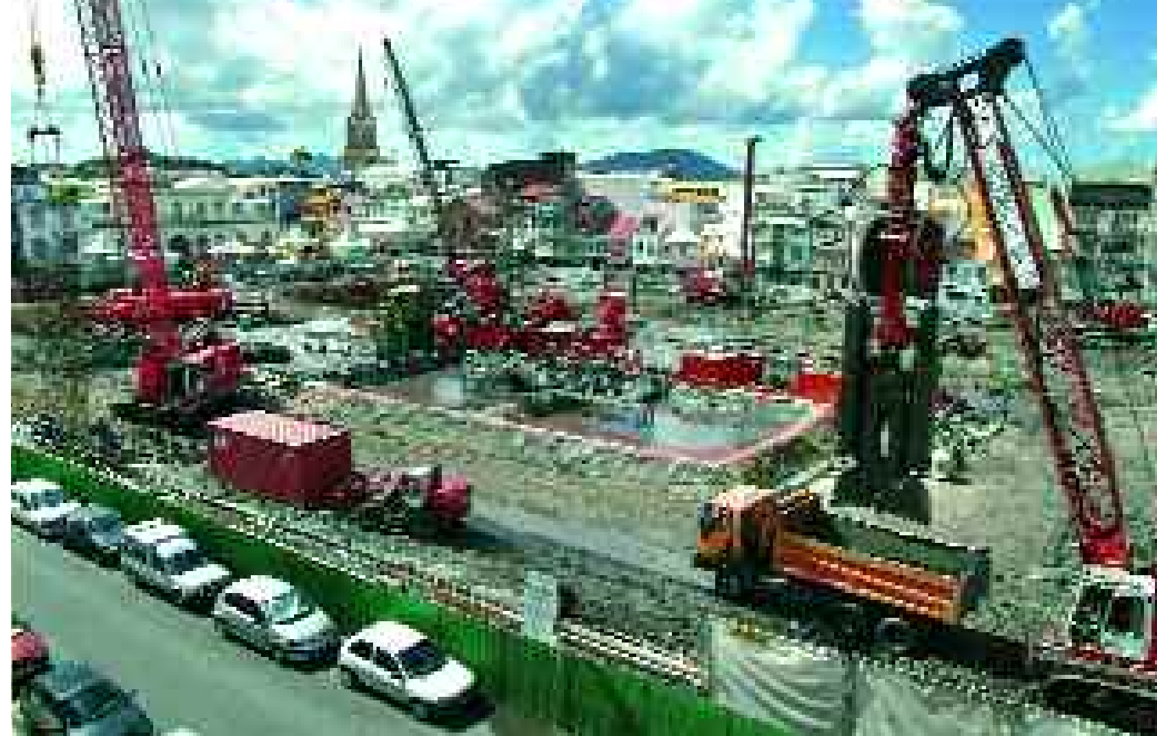
Le parking Perrinon représente l'un des plus grands chantiers de fondations des Antilles.
