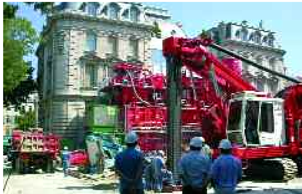
L'hydrofraise HC03 et sa centrale de fabrication et de traitement de boue SOTRES 400m 3 ; en arrière plan, le bâtiment de la Caisse d'Epargne
